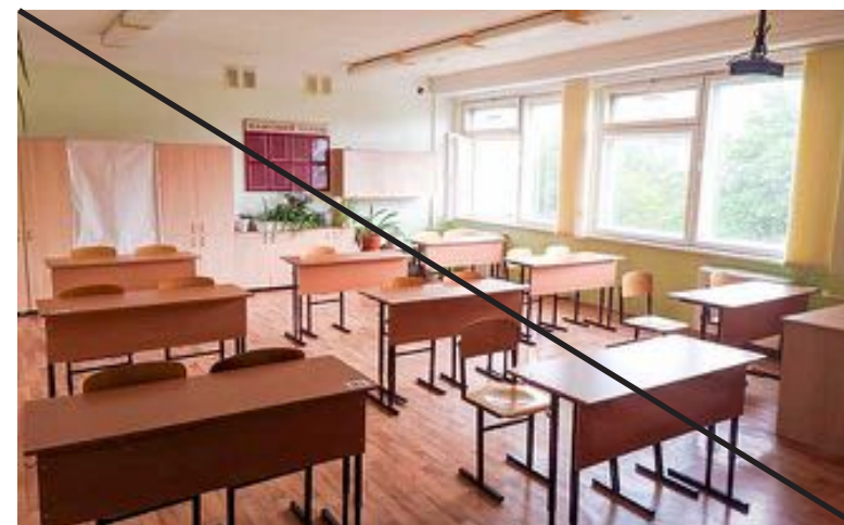
Плохо Линолеум под дерево
